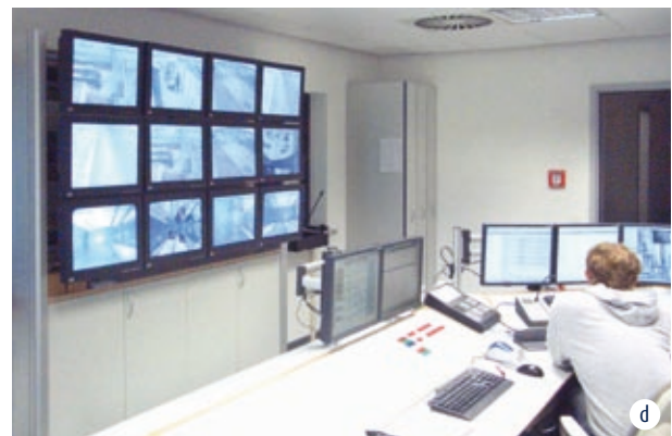
Integration von Monitorwänden im gleichen System möglich.
