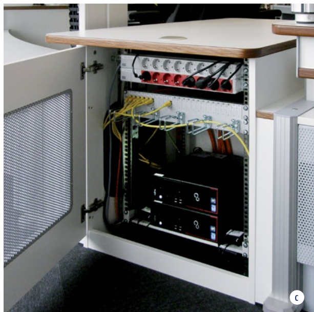
19" Technik im nebenstehenden Technikcontainer
